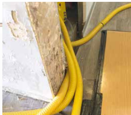
Rohrbrüche erforderten zahlreiche Reparaturarbeiten
